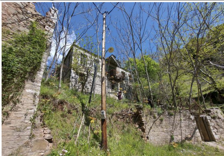
Εικόνα 3-28. Οικία Καραγεώργου. Διακρίνεται ο τοίχος αντιστήριξης στο όριο της ιδιοκτησίας, του οποίου τμήμα έχει καταρρεύσει. Πηγή: Ερευνητική ομάδα ΕΜΠ, 2023. Σχέδια: Α. Βιέννα, Α. Ζαχαράκη, Ζ. Κονδύλη, Ν. Σάκκα, Β. Λασπιά, Ο. Σπυριδάκη, Α. Στεφανή, Δ. Χρήστου, μεταπτυχιακές φοιτήτριες ΔΠΜΣ «Προστασία Μνημείων» ΕΜΠ.
